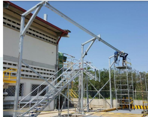
ESTACIONES DE INSPECCIÓN DE COMBUSTIBLE (SYGENTA- CARTAGENA)
